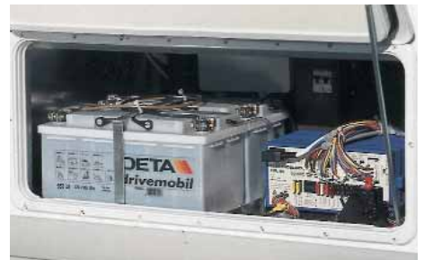
Die Platzierung unserer Komponenten erfolgt genau dort, wo sie gebraucht werden. Wartungsfreundlich und voll integriert im modularen System.
